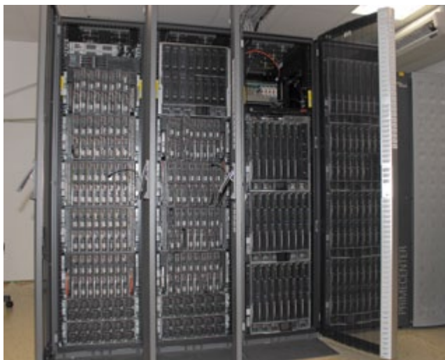
Moderní servery a datová uložení obsahují údaje o milionech klientů ČSSZ
